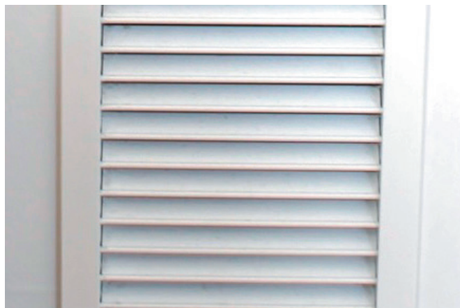
reixes retorn aire condicionat
